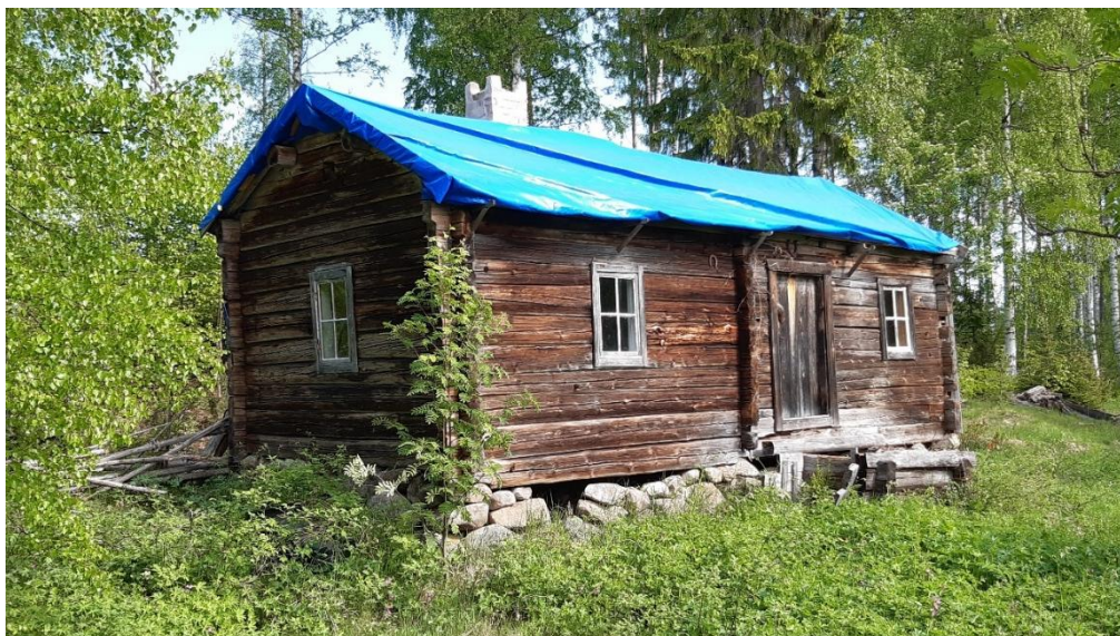
Figur 4. Den aktuella vallstugan från söder med presenning över taket innan renoveringen inleddes. Observera skorstenen som då saknade en flat sten överst. Foto: Daniel Olsson, 2024-05-28.
