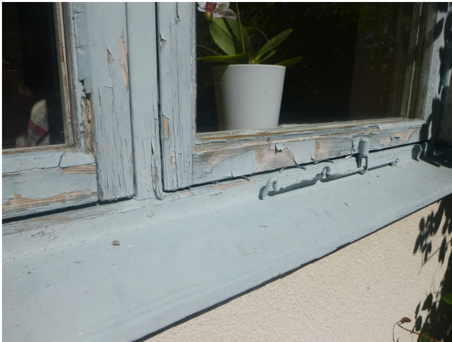
Kitt-och färgsläpp fönster.
