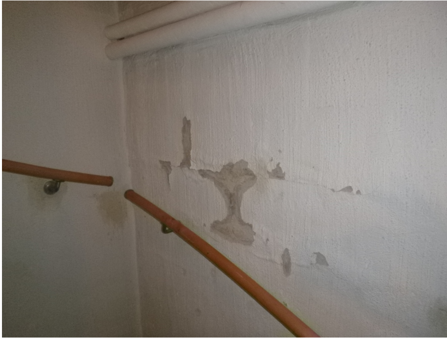
Fuktgenomslag genom yttervägg/grundmur, källartrappa.
