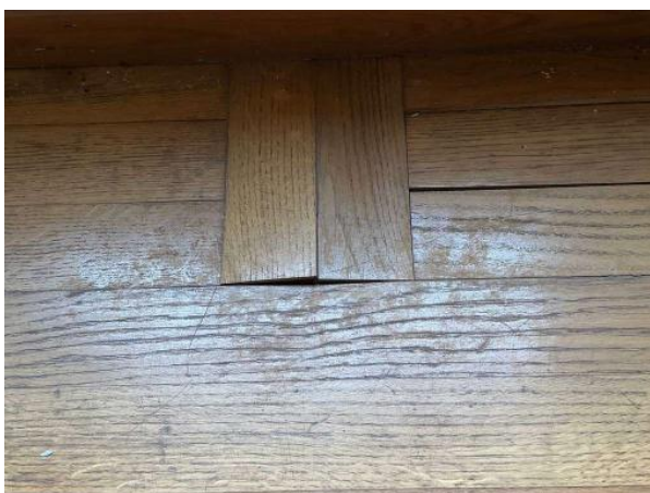
Bild 6: Invändigt, Entréplan, Skador noterades i golvet
