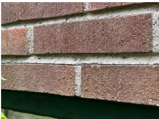
Bild 1: - Utvändigt, Fasad, Färgsläpp och sliten träpanel ovan ett fönster Tegelrad har delvis släpp ovan fönster
