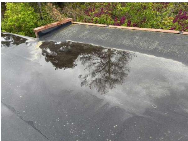
Bild 3: - Utvändigt, Yttertak, Det är för lågt uppvik av papp mot plåtar Stående vatten noterades på taket Se riskanalys
