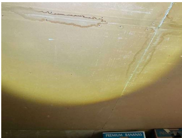
Bild 4: - Utvändigt, Övrigt, Delvis belamrat i vägg och golvvinkel Spår av tidigare läckage noterades i tak
