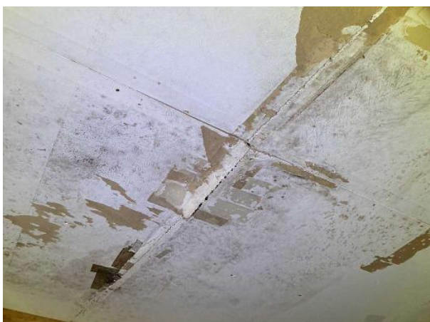
Bild 5: Utvändigt, Övrigt, Spår av tidigare läckage i taket, se riskanalys
