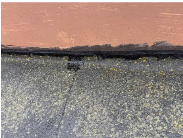
Bild 2: - Utvändigt, Yttertak, Det är för lågt uppvik av papp mot plåtar Stående vatten noterades på taket Se riskanalys
