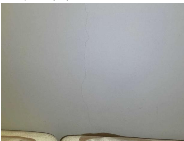
Bild 10: Invändigt, Soutterrängplan, Rörelse sprickor noteras på väggar
