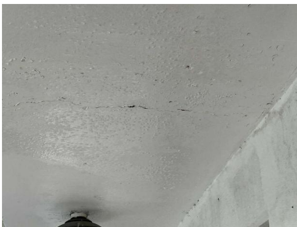
Bild 8: - Utvändigt, Yttertak, Äldre tak Färgsläpp noteras på takutskjutet från garaget ...
