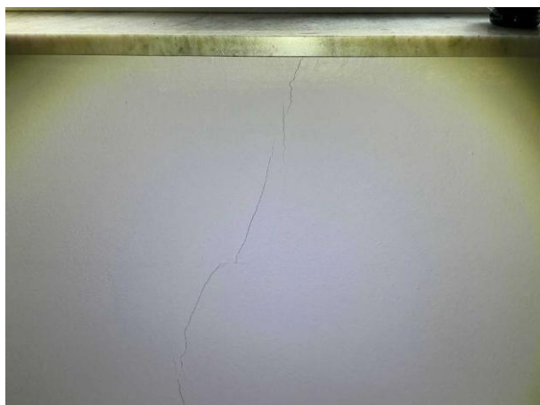
Bild 13: Invändigt, Soutterrängplan, Spricka noteras på vägg
