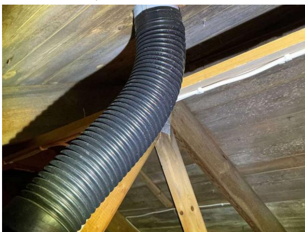
Bild 6: - Utvändigt, Vind, Mikrobiellpäväxt och fuktrosor noteras på underlagstaket
