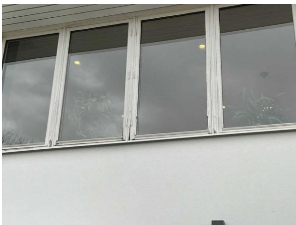
Bild 4: - Utvändigt, Fönster, Färgsläpp noteras på fönster Rötskada noteras på enskilda fönster
