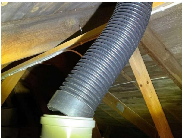
Bild 7: - Utvändigt, Vind, Avluftningen till avloppsrören är otät i skarven
