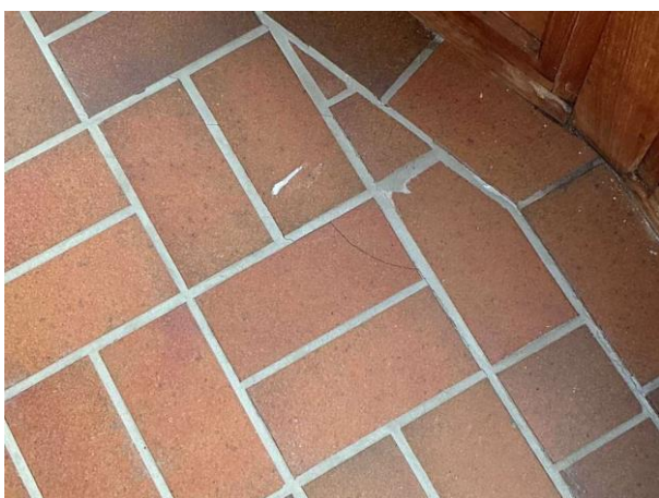
Bild 9: - Invändigt, Soutterrängplan, Spricka noteras på klinker Det noterades s.k. bomljud på klinkerplattor (det låter ihåligt när Ma....
