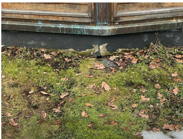
Bild 2: - Utvändigt, Grundmur/Hussockel, Färg Putssläpp på hussockeln
