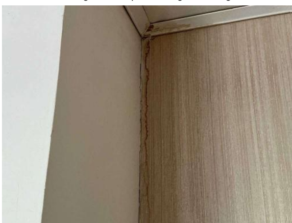
Bild 4: Invändigt, Överväning, Fuktbläck på vägg vid kaminen (torrt vid besiktningstillfället)
