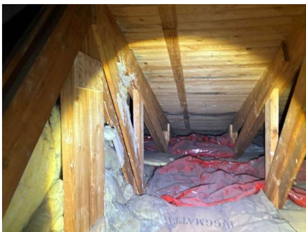
Bild 2: - Utvändigt, Vind, Spår av tidigare läckage
