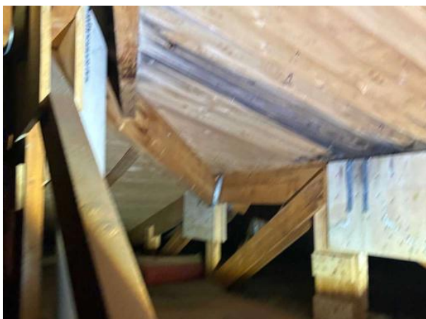
Bild 1: - Utvändigt, Vind, vinden Spår av tidigare läckage
