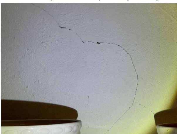
Bild 3: Invändigt, Entréplan, Spricka noterades i väggen
