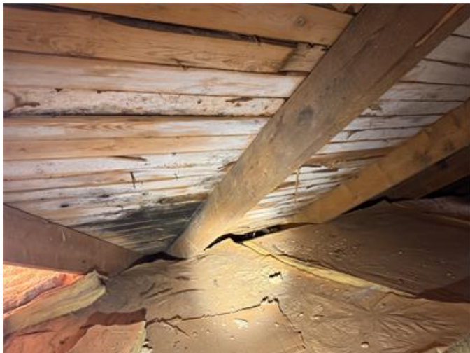
Bild visar mikrobiell påväxt mot underlagstak.
