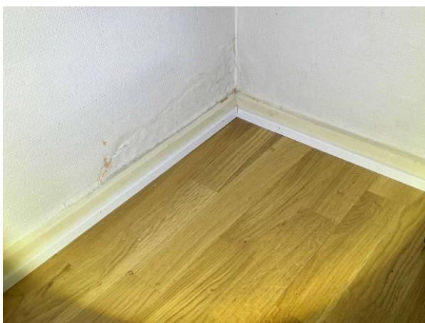
Bild 4: Invändigt, Souterrängplan, Fuktgenomslag i källarväggens nedre kant se fortsatt teknisk utredning
