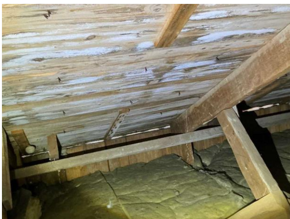
Bild 2: - Utvändigt, Vind, Huset är självdragsventilerat se riskanalysen Varmvind ovan klädkammare i tillbyggd del inget så...
