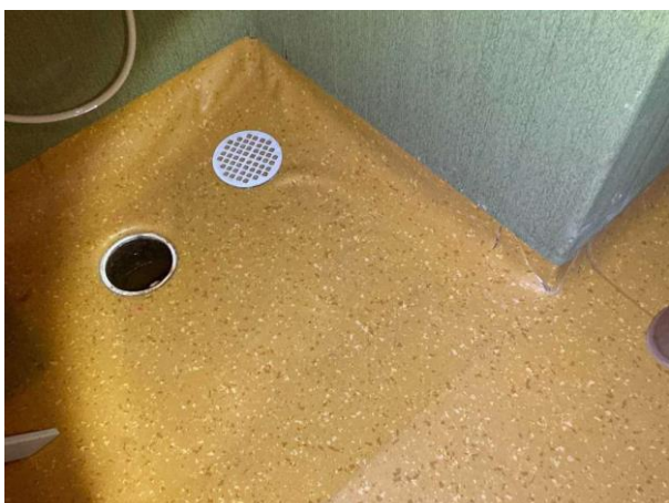
Bild 5: - Invändigt, Souterrängplan, Äldre våtrum med direkt renoveringsbehov Plastmattan lös runt golvbrunn Äldre gjutjärnsbrunn Kl...
