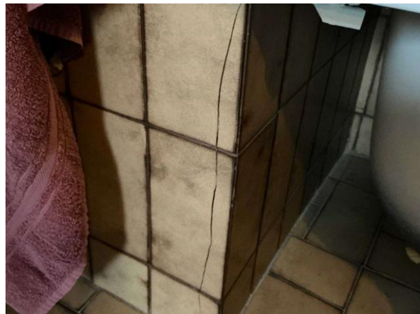
Bild 10: - Invändigt, Övervåning, Äldre våtrum med renoveringsbehov se riskanalysen Spricka i kakel under badkaret Äldre gjutjärn...
