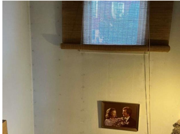
Bild 8: Invändigt, Övervåning, Köldbryggor noterades på innerväggar
