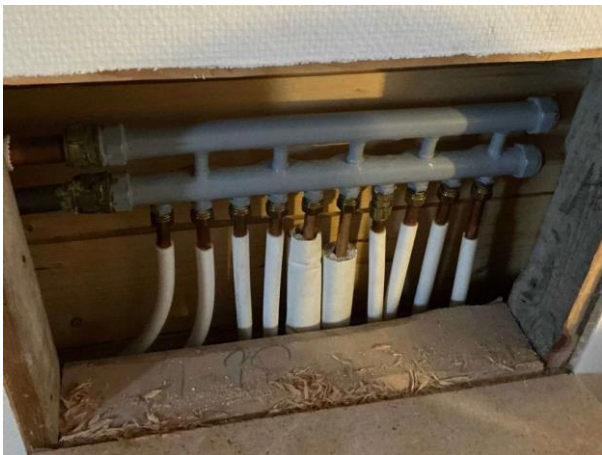
Bild 9: Invändigt, Övervåning, Inbyggda vattenkopplingar saknas bakomliggande tätskikt och skvallerrör
