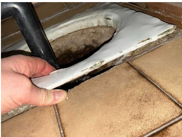
Bild 11: - Invändigt, Övervåning, Äldre våtrum med renoveringsbehov se riskanalysen Spricka i kakel under badkaret Äldre gjutjärn...
