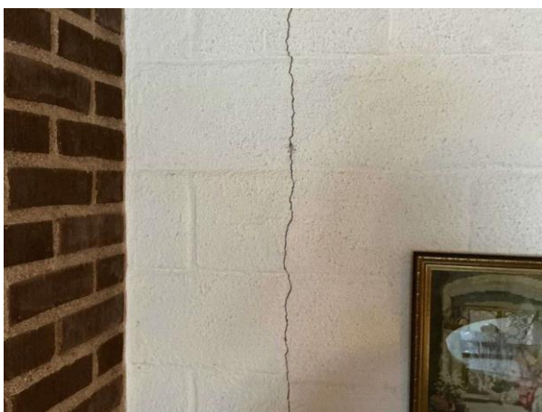
Bild 6: - Invändigt, Souterrängplan, Krympspricka mellan murstock och innervägg samt mindre sprickor i ytterväggar noterades Tät bott...
