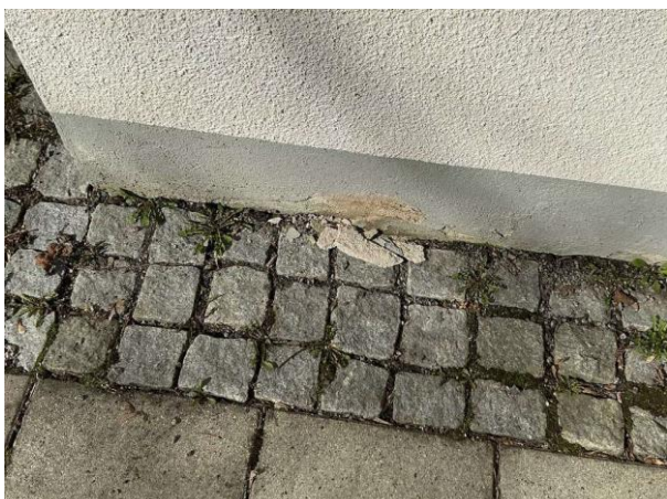
Bild 1: - Utvändigt, Grundmur/Hussockel, Putssläpp lös puts på grundmur noterades på utbyggnad Ej besiktat under altan
