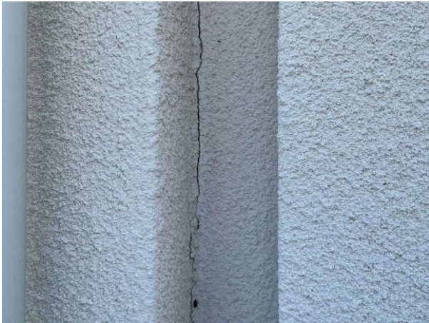
Bild 7: - Utvändigt, Fasad, Sprickor och bomputs/lös puts noterades lokalt Otät plåt vid tillbyggnaden vägg/plåt Lös puts vid...
