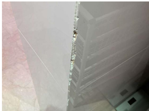
Bild 16: - Invändigt, Entréplan, Don saknas på frånluftskanal Svårt att besikta bakom panna och tvättmaskin Rör i golv förekommer...
