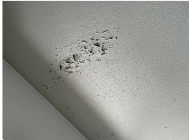
Bild 14: - Invändigt, Entréplan, Renoverat 2009 Kvalitetsdokument saknas Golvbrunnens anslutning till klämringen är dold av sättbr...
