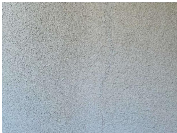
Bild 2: - Utvändigt, Fasad, Sprickor och bomputs/lös puts noterades lokalt Otät plåt vid tillbyggnaden vägg/plåt Lös puts vid...
