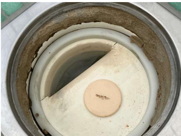
Bild 17: - Invändigt, Övervåning, Äldre våtrum se riskanalysen Äldre golvbrunn av plast Brunnsduk saknas mellan klämringen och gol...
