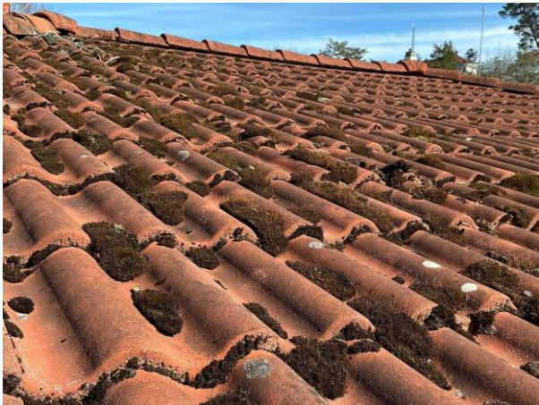
Bild 9: - Utvändigt, Yttertak, Äldre tak se riskanalysen Mossa noterades på taket Nockduk saknas under nockpannor Regnskydd sak...
