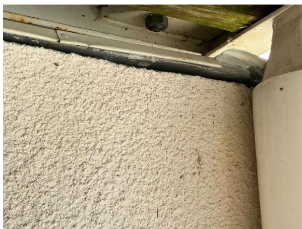
Bild 4: - Utvändigt, Fasad, Sprickor och bomputs/lös puts noterades lokalt Otät plåt vid tillbyggnaden vägg/plåt Lös puts vid...
