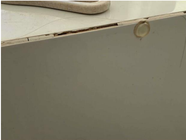
Bild 13: - Invändigt, Entréplan, Renoverat 2009 Kvalitetsdokument saknas Golvbrunnens anslutning till klämringen är dold av sättbr...
