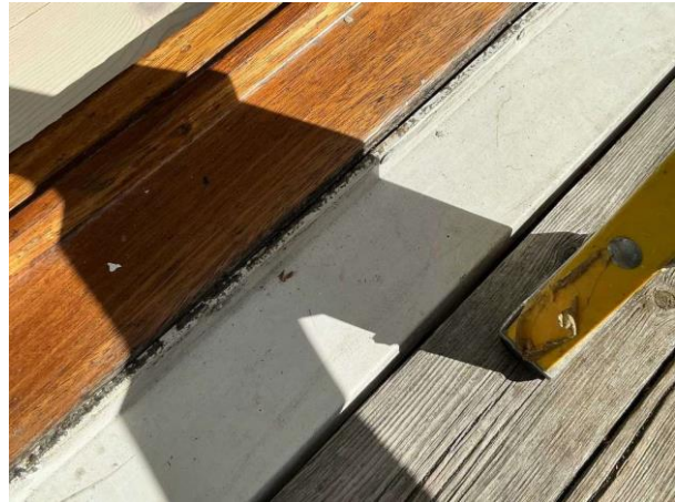
Bild 8: Utvändigt, Ytterdörr, Bleck på altandörr glipar mot tröskel
