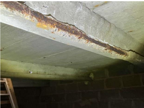
Bild 5: - Utvändigt, Krypgrund under garage, Rost och synlig armering på balkar där betongen lossnat (reoveringsbehov) Spår av läckage under ...
