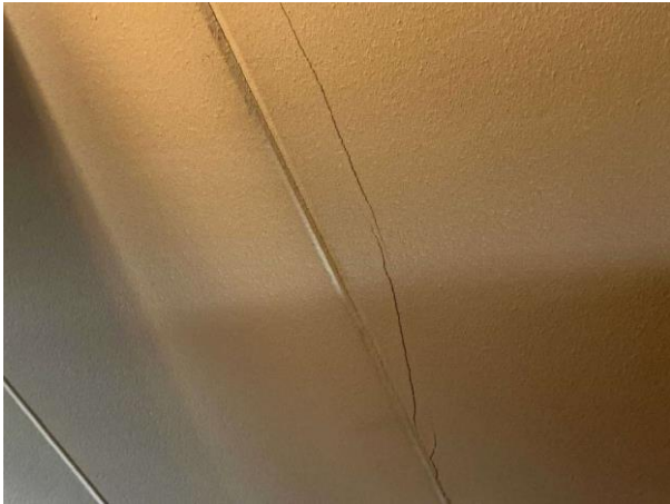
Bild 7: Invändigt, Entréplan, Spricka i bjälklagselement
