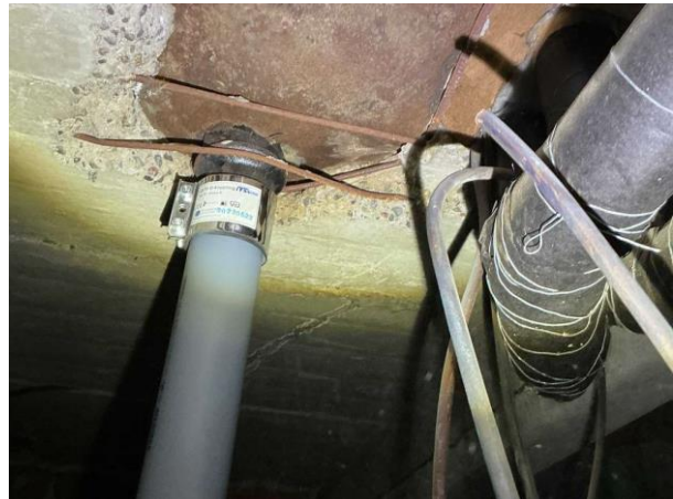
Bild 4: - Utvändigt, Krypgrund under garage, Rost och synlig armering på balkar där betongen lossnat (reoveringsbehov) Spår av läckage under ...
