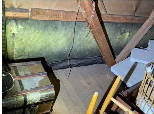
Bild 2: - Utvändigt, Vind, Spår av äldre läckage noterades lokalt på underlagstakets räspont Missfärgad svart isolering note...
