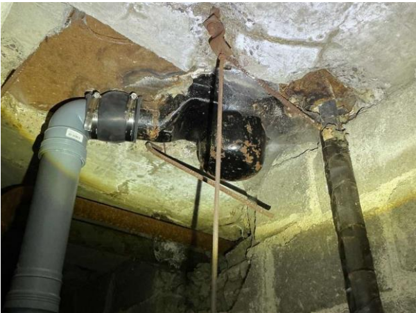
Bild 3: - Utvändigt, Krypgrund under garage, Rost och synlig armering på balkar där betongen lossnat (reoveringsbehov) Spår av läckage under ...
