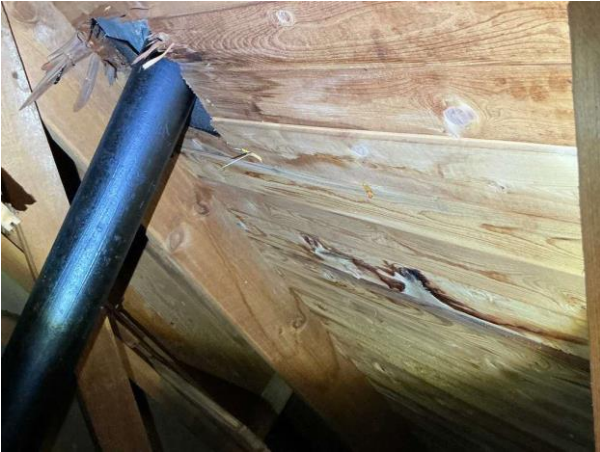
Bild 1: - Utvändigt, Vind, Spår av äldre läckage noterades lokalt på underlagstakets räspont Missfärgad svart isolering note...
