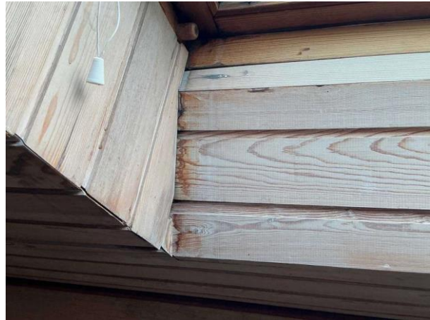
Bild 8: - Invändigt, Överväning, Spår av läckage vid takfönster (torrt vid besiktningen) Takfönster är av äldre modell och bör byt...
