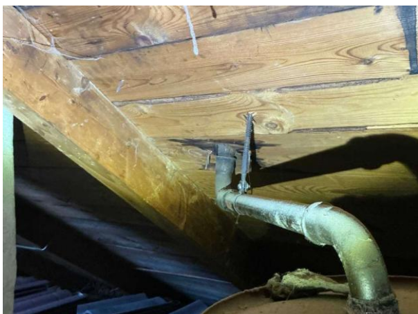
Bild 7: - Utvändigt, Vind, Fuktros noteras vid äldre rörgenomföing från expansionskärl
