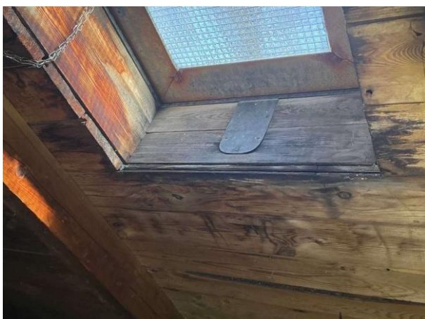
Bild 5: - Utvändigt, Vind, Äldre otät taklucka med fuktrosor runt
