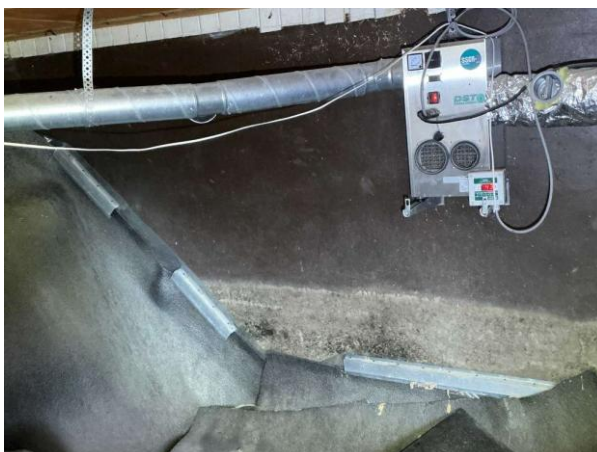
Bild 2: - Utvändigt, Grund, krypgrund som är avfuktad i efterhand
