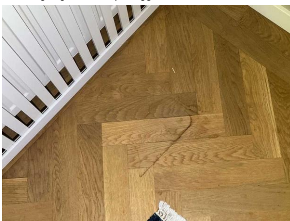
Bild 12: Invändigt, Entréplan, Fläck noteras på golv
