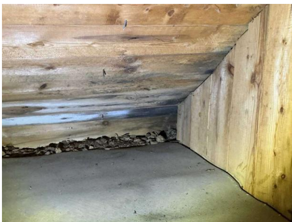
Bild 8: - Utvändigt, Vind, Mikrobiellpåväxt noteras på underlagstaket
