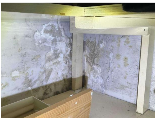
Bild 10: Invändigt, Källarplan, Färgsläpp. Sprickor och missfärgningar noteras på väggar
