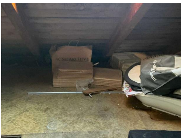
Bild 6: - Utvändigt, Vind, Fukt noteras på golvbjälklaget under taklucka
