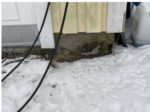
Bild 1: Utvändigt, Grundmur/Hussockel, Sprickor och färgsläpp noteras lokalt på grundmuren
