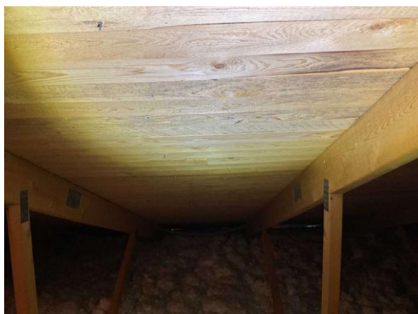
Bild 3: - Utvändigt, Vind, Lokalt på vinden noterades det mikrobiell påväxt på underlagstaket (håll under uppsikt)
