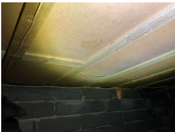
Bild 2: - Utvändigt, Grund, Tryckimpregnerat trä noteras i grunden Enstaka fläck noteras på golvbjälklagets botten
