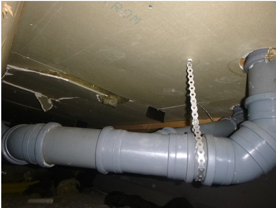
Skadad trossbottenskiva/bakfall avloppstam, kryppgrund.
