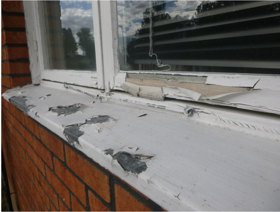
Kitt-och färgsläpp på fönster.
