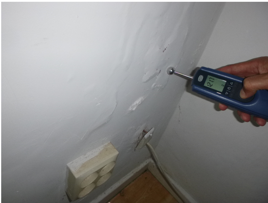
Färg-och putssläpp i yttrevägg, yttre hörn gillestuga.
