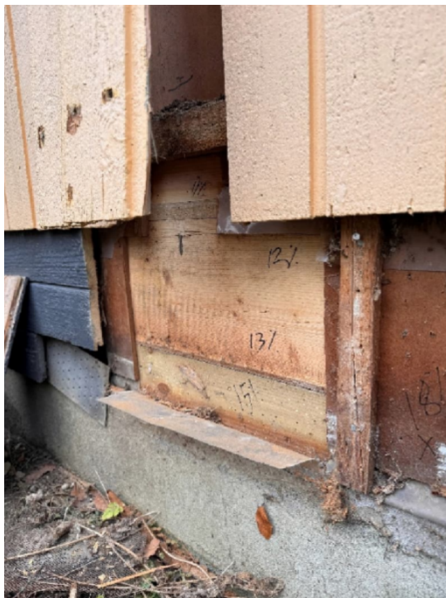
Bild på ytterväggsanslutning mot krypgrundsbjälklag. Nederst på sockeln syns den yttre bärlinan som bjälklaget är upplagt på.
